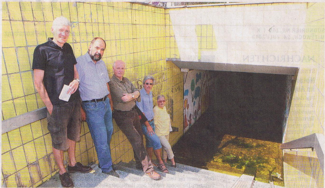
Stein des Anstoßes: Seit März steht die Unterführung in Allmannsdorf unter Wasser, weil die Pumpe defekt ist. Dies bedauern (von links) Sven Martin (Bürgervereinigung), CDU-Stadtrat Andreas Ellegast, Alexander Gebauer (Bürgervereinigung), Thomas Choinowski (Elternvertreter) und Dorothee Schmidt (Stadtseniorenrat). BILDER: HANSEN
